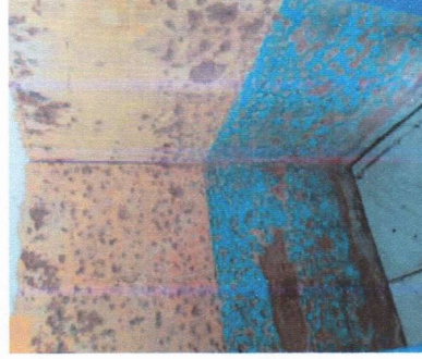
FOTO 4 APOICAMENTO DE REBOCO
